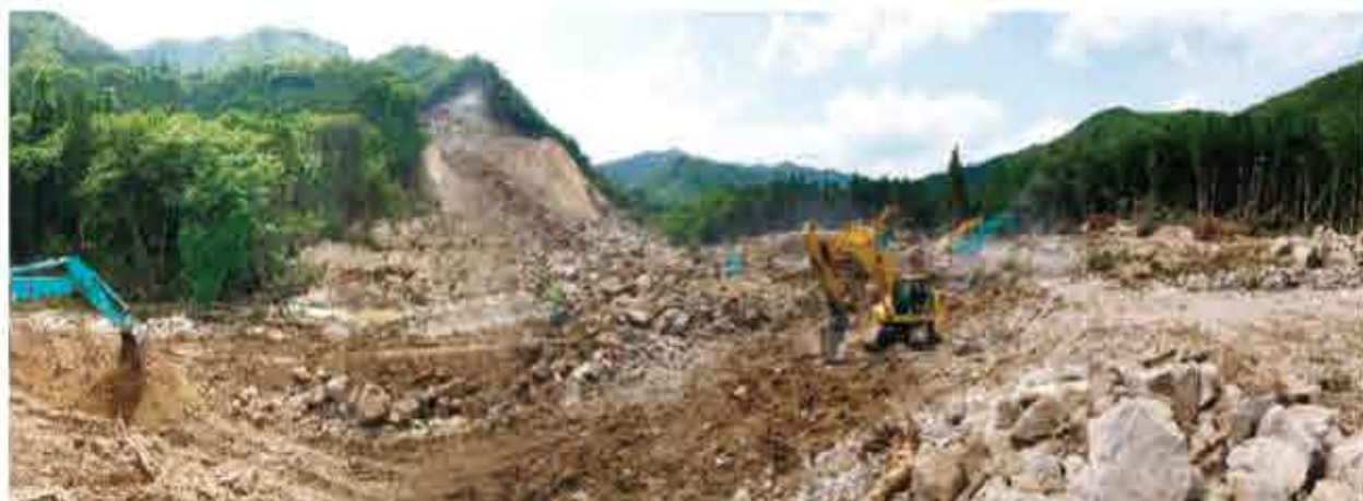
岩手・宮城内陸地震で被災の小川原地区応急復旧
